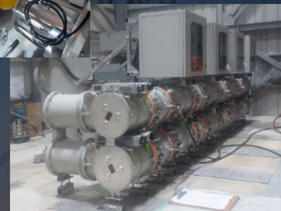
Celdas GIS culminadas
