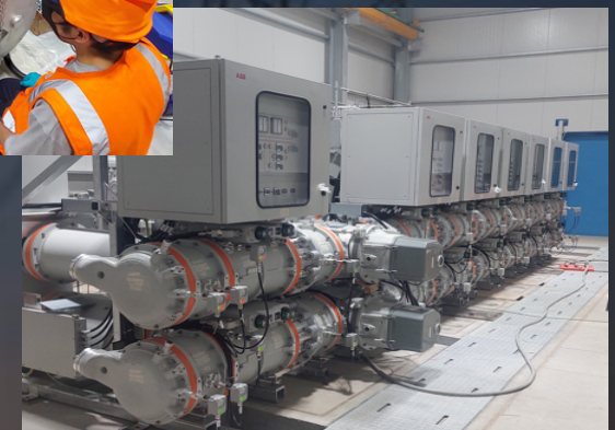
Celdas GIS culminadas
