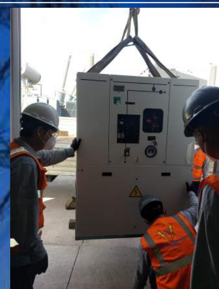
Celdas Nuevas a instalar
