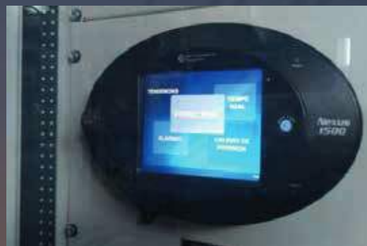
Configuración del medidor de energía
