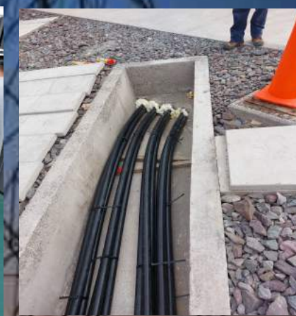
Peinado de cables de media tensión
