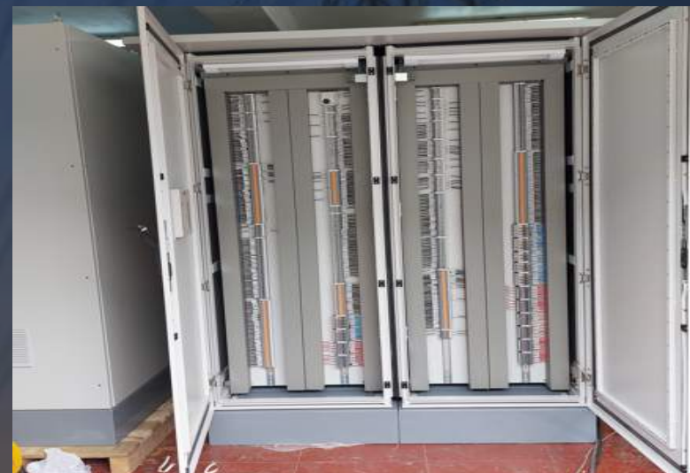
Cableado y timbrado de tableros para uso exterior
