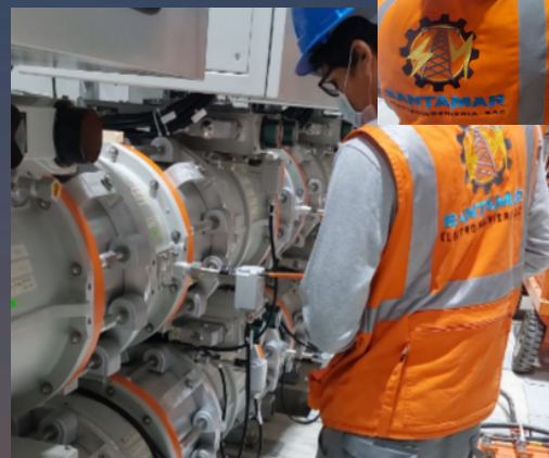
Conexionado de densímetros
