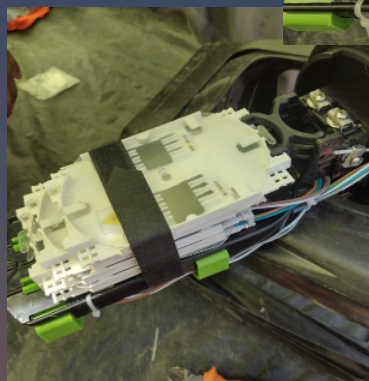
Mufa terminada y adecuadamente ordenada
