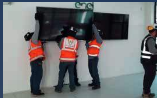
Terminaciones correctamente instaladas
